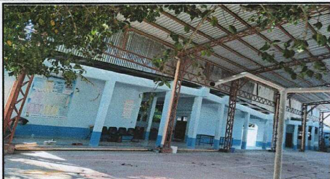
MODULO 1 : Sustitución caída de agua Pluvial con salida a la calle, tubería que esta quebrada, destruida por el paso del tiempo.
